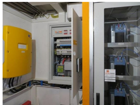
Abbildung 1: SMA Sunny Island (links) und Batteriezellen (rechts)
