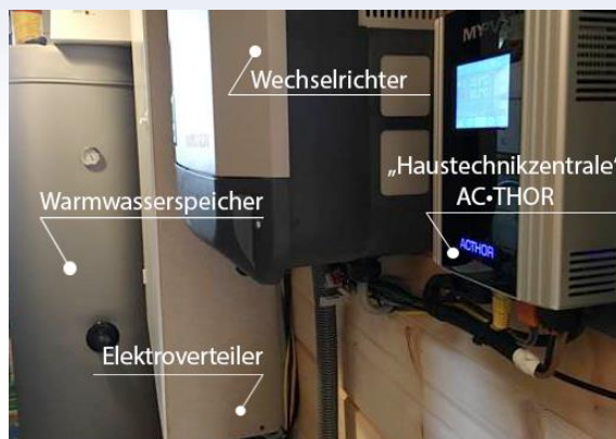
Abbildung 6: Die gesamte Haustechnik auf kleinstem Raum
